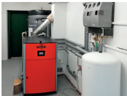
Vzorová kotelna s kotlem ROJEK PK BIO
